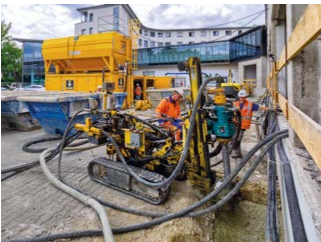
Nachgründung Industriegebäude, München, Deutschland Für die Aufstockung wurden 130 Säulen bis in eine Tiefe von ca. 8 m mittels Hochdruckinjektion ausgeführt.
