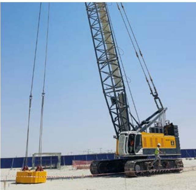
Dubai Creek Harbour, Dubai, VAE Verbesserung des Baugrundes auf ca. 500.000 m 2 mittels Rütteldruck- und dynamischer Intensivverdichtung.
