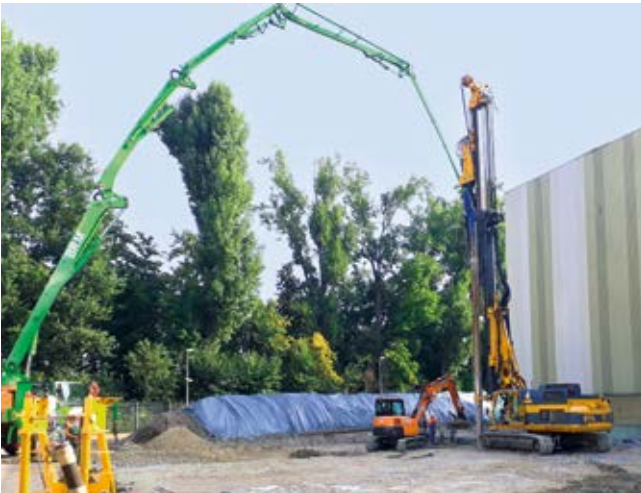
Logistikzentrum, Karlsruhe, Deutschland Für die Gründungsarbeiten eines Logistikzentrums führte Bauer 2.700 m Rüttelortbetonsäulen aus.
