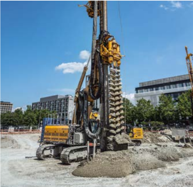
Parkstadt Schwabing, München, Deutschland Herstellung einer 6.000 m 2 einfach rückverankerten Mixed-in-Place-Dichtwand für eine 9 m tiefe Baugrube.
