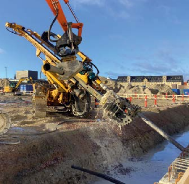
Operaparken, Kopenhagen, Dänemark Rückverankerung einer Schlitzwand in zwei Ankerlagen mit insgesamt 186 Litzenkurzzeitanker.
