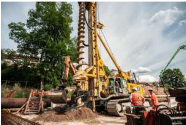
(2) Als Baugrubenumschließung stellt die BAUER Spezialtiefbau GmbH eine überschnittene Pfahlwand bis in ca. 24 m Tiefe her.
